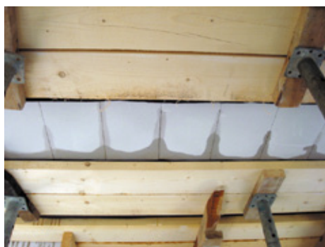
Цементное молочко, проникающее между блоками при заливке бетона, надежно связывает блоки между собой
